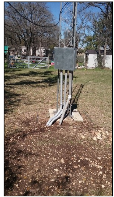
Rohn 35G & Conduits
